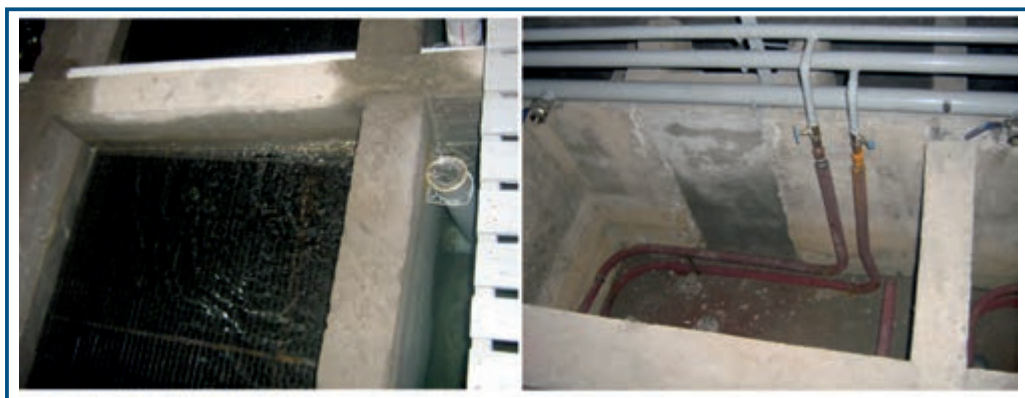
Рис. 12. Механический фильтр и дренажная труба (слева), бассейн для насоса с теплообменником от центральной системы отопления (справа), вид сверху.
