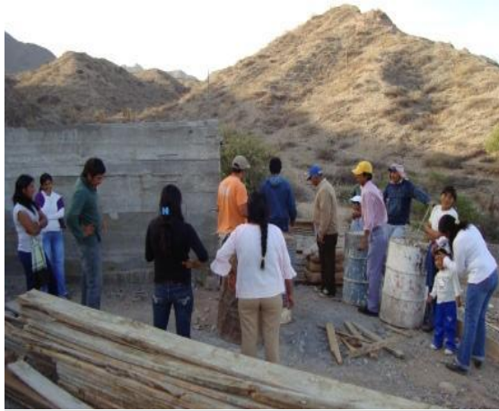
Cisterna de agua, en el proyecto de Agua en la comunidad El Churcal, Valles Calchaquíes, Salta.
