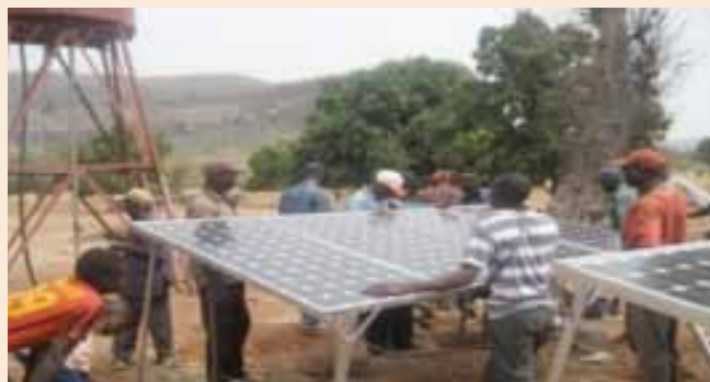
Mise à disposition de l'eau grâce aux panneaux solaires photovoltaïques
